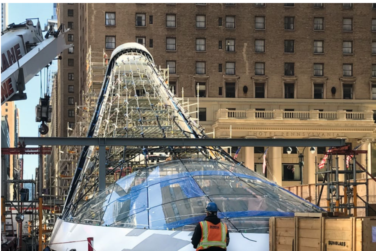
Die anspruchsvolle Montage mitten in Manhattan erforderte eine geschickte Koordination der Installationsphasen. © seele
