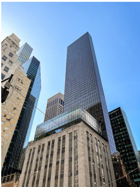
Für den neu gestalteten Flagship Store von Tiffany & Co., der nun den Namen „The Landmark“ trägt, setzte seele den Erweiterungsbau auf Ebene 8 bis 10 um. © seele
